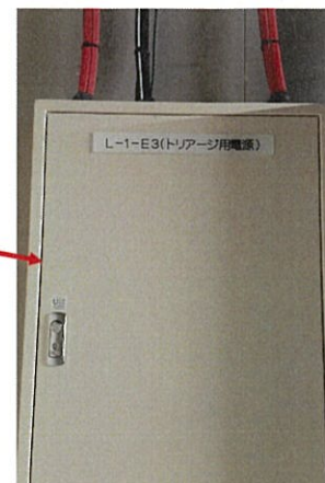
写真② 災害対策用電源取設
