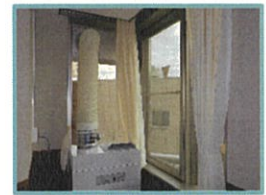
陰圧装置付き病室 4室 (他1室:南病棟3階)
